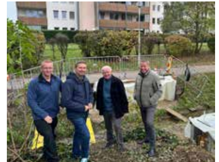
Die Verantwortlichen vor Ort: Verkehrsreferent Manfred Leitner, Bürgermeister Markus Hofko, Planender Hans Haller und Infrastrukturreferent Michael Balazs begutachten die Brückenbaustelle am Seilerweg.
